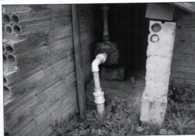
Figura 12: - Poço de captação de água ..
